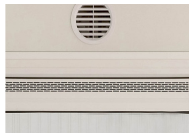
Rolluik en ventilatierooster
